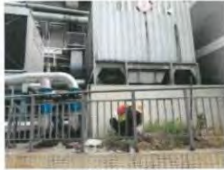
电镀污水处理站北侧
