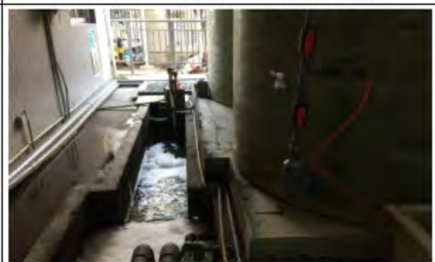
图19 总排口在线监控
