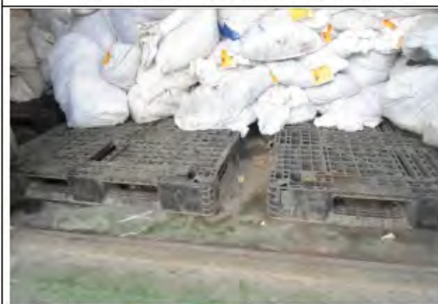
图13 危废仓库围堰及地面防腐防渗
