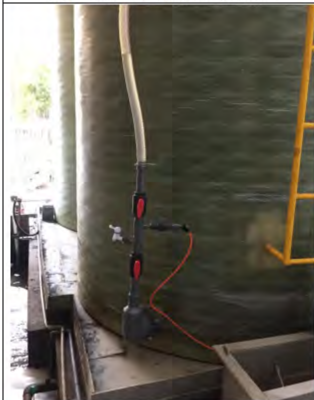
图20 电镀废水不达标暂存桶及废水处理站围堰
