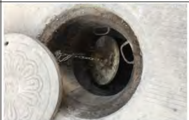
图23 雨水排放口应急闸门
