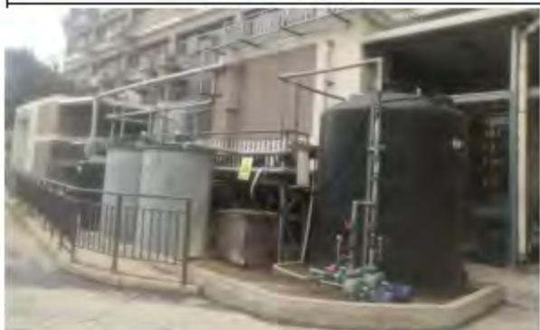
图7 电镀废水处理设施
