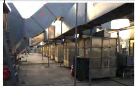
图8 废气处理设施
