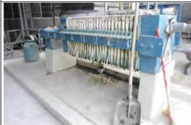
图15 电镀污泥压滤机区域围堰
