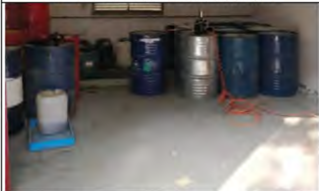
图11 危化品仓库托盘及地面防腐防渗
